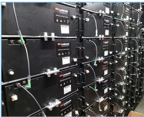
Abb. 12 Batterie Speicher aus Li-Ion Batterien.
